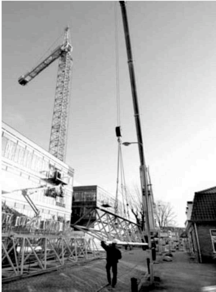
Er moet een andere kraan aan te pas komen om één van de grote bouwkransen bij het ROC te ontmantelen.
